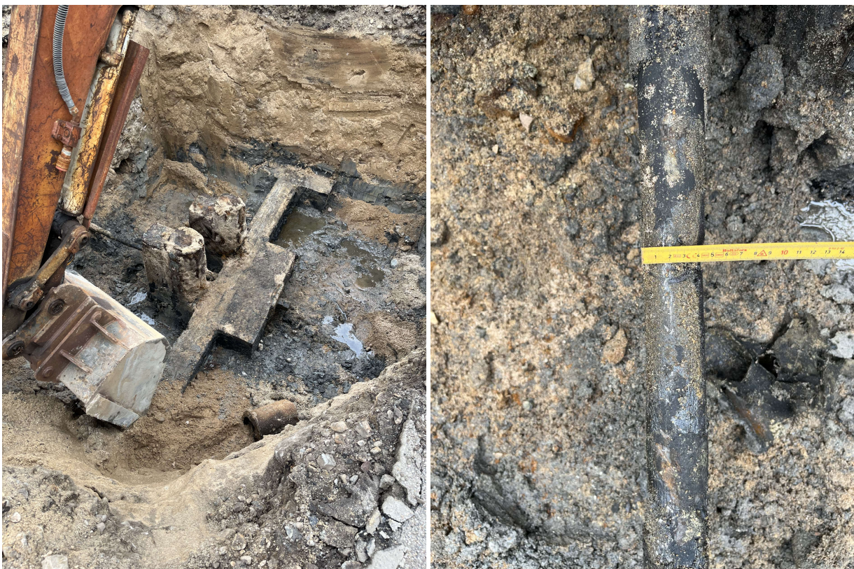
Billeder af opgravning ved en ankerbuk. Tilstandsvurdering af et anker og synlig buk (træ).
